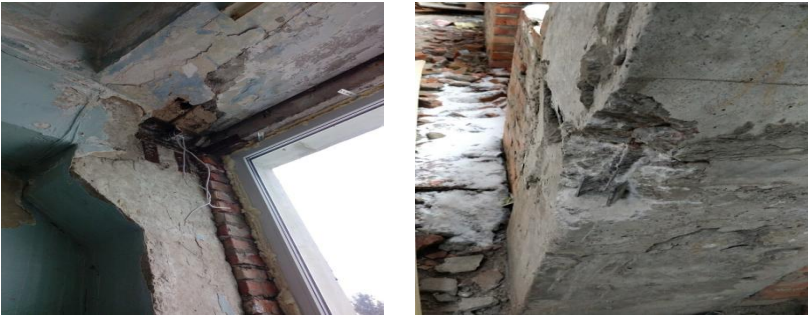
Рис. 1. Натурні обстеження конструкцій, ушкоджених корозією
