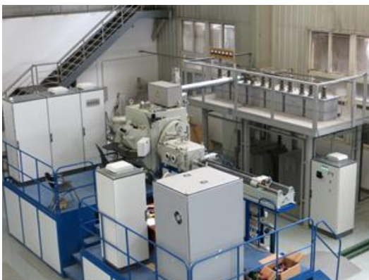
Рис. 1. Загальний вигляд установка Л2
