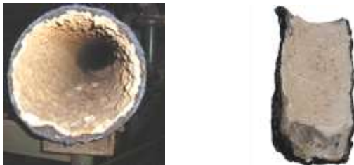
Рис. 1. Накип що утворилась на внутрішніх поверхнях теплообмінника
