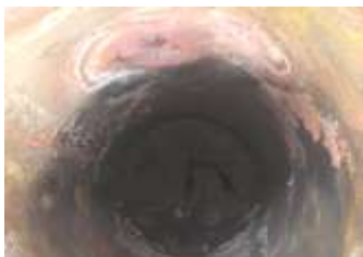
Рис. 2. Наслідок дії лужної корозії теплообмінника
