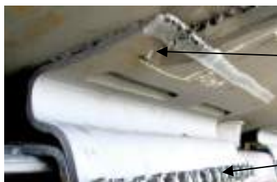
Рис.2. Трещины фасонной лапы
